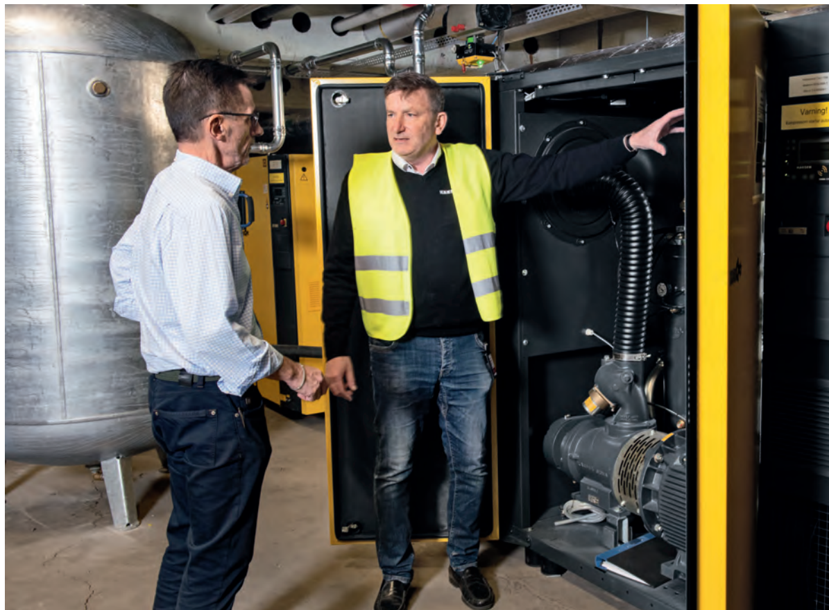
Lars-Göran Larsson hablando con Bengt Fristorp, ingeniero de ventas de KAESER, sobre el mantenimiento de los compresores.
