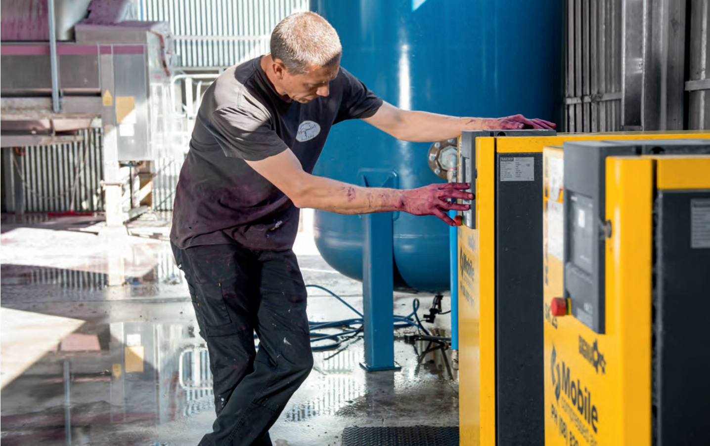
La nueva estación de aire comprimido de Teusner: dos compresores de tornillo KAESER SK 25 y un tanque de aire comprimido con una capacidad de 5000 litros.
